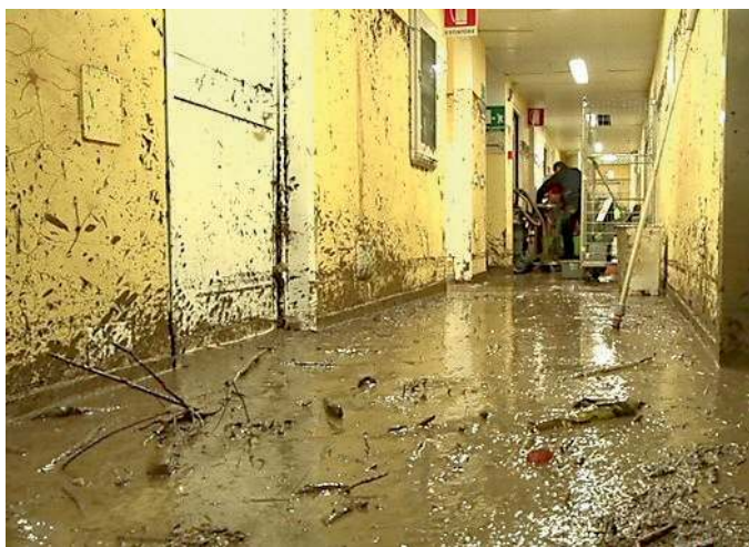
L’ospedale “inondato” durante l’alluvione dell’ottobre 2024
