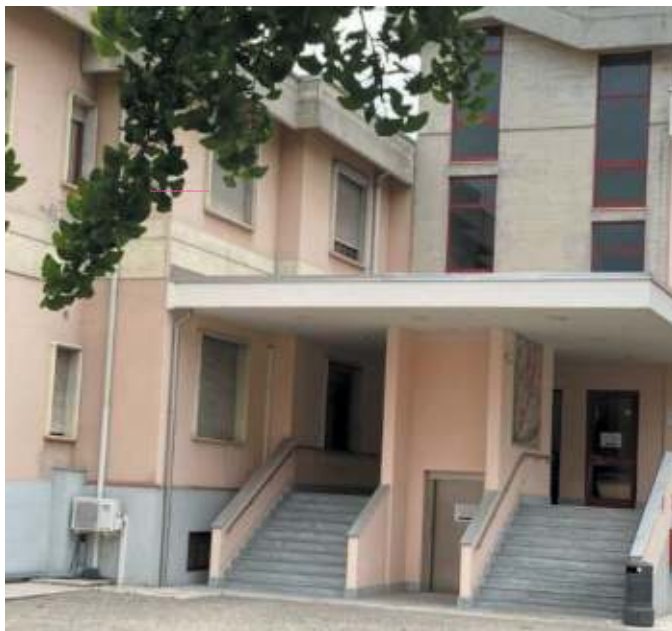
L'ospedale di Cairo ha subito danni e interruzioni per l'alluvione
