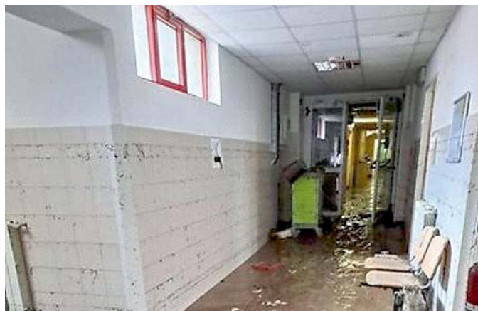
I danni dell'alluvione al presidio sanitario sono stati notevoli
