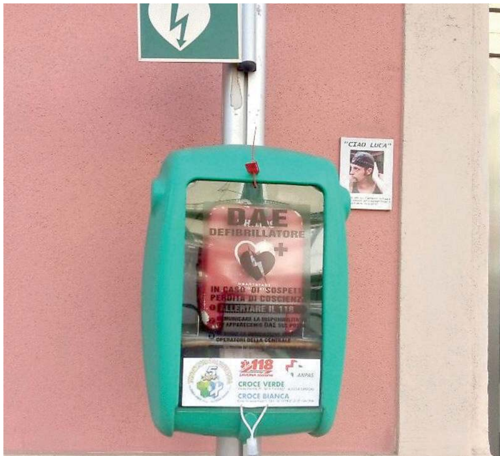
Un defibrillatore portatile da colonnina installato nel quartiere di Zinola
