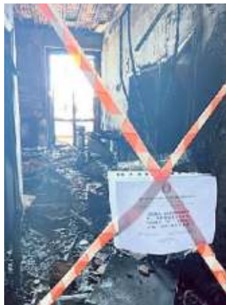
I danni dell'incendio a Pietra
