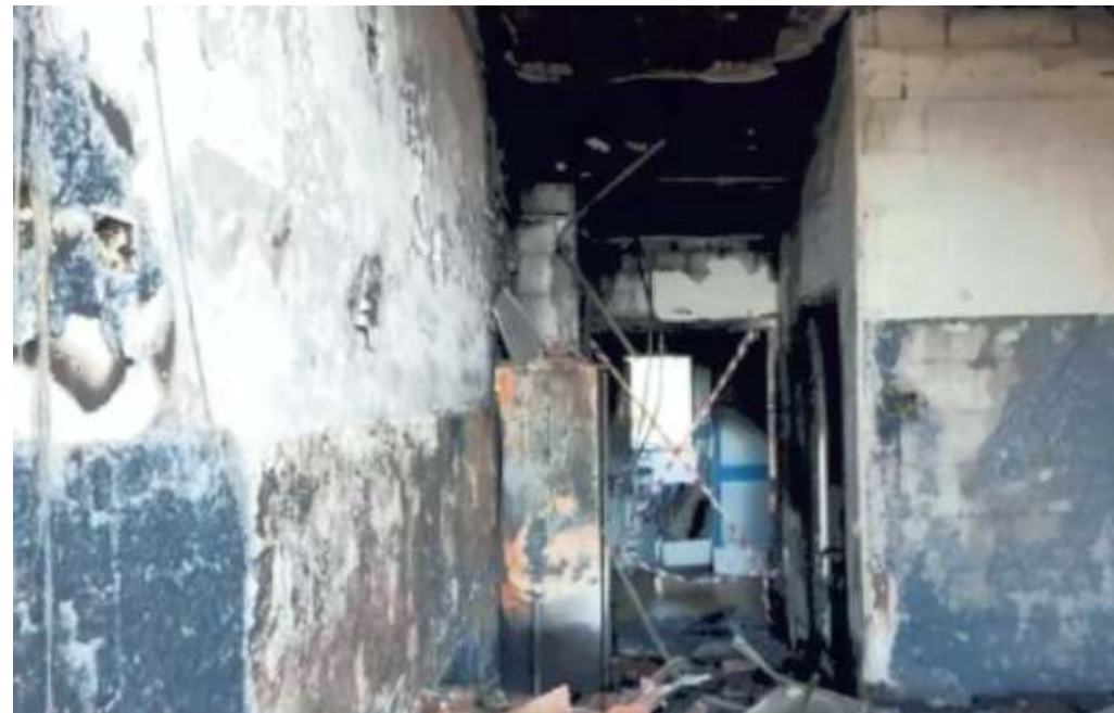
Una delle camere andate a fuoco nel reparto di ortopedia del santa Corona di Pietra Ligure
