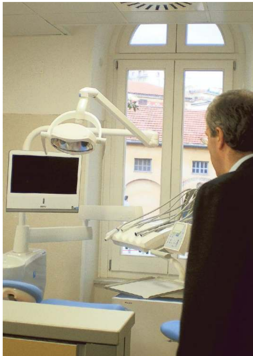
Apparecchiature nella parte delle ex Boschine di Varazze già utilizzata da Asl
