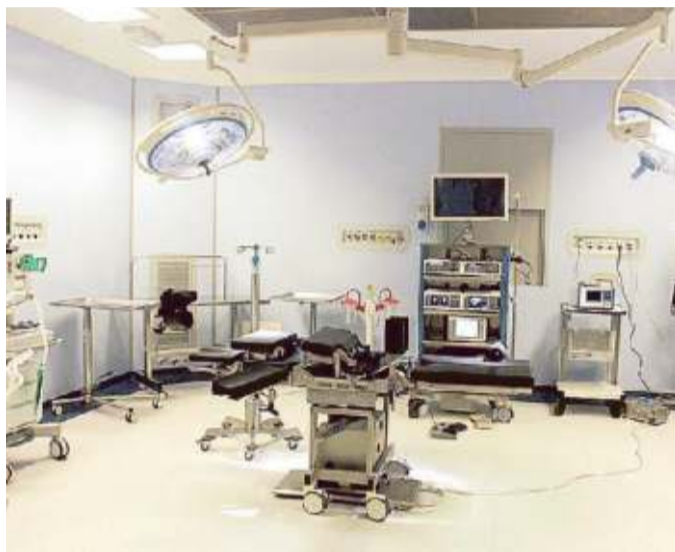
Le camere operatorie di ortopedia dell'ospedale di Albenga
